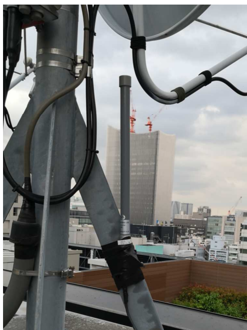
基地局:八重洲ビル屋上
